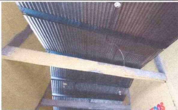
Foto 3: Se observa la instalación eléctrica en mal estado, sin uso debido a daños en cables de alimentación y accesorios eléctricos.
