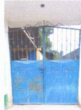
Foto 2: Se observa el porton de acceso principal con deterioro y mucho desgaste por falta de mantenimiento.
