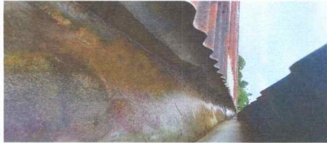
Foto 1: Se observa el canal metálico de las bajadas de aguas pluviales con desgaste, óxido y deterioro.
