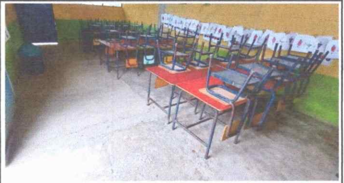
Foto 4: Se observa el deterioro y el agrietamiento del piso de concreto actual en las aulas.
